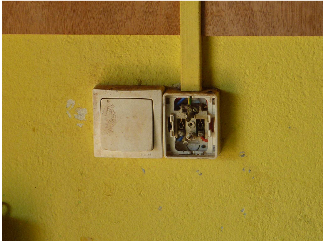
Détail d'un interrupteur électrique dans une classe.
