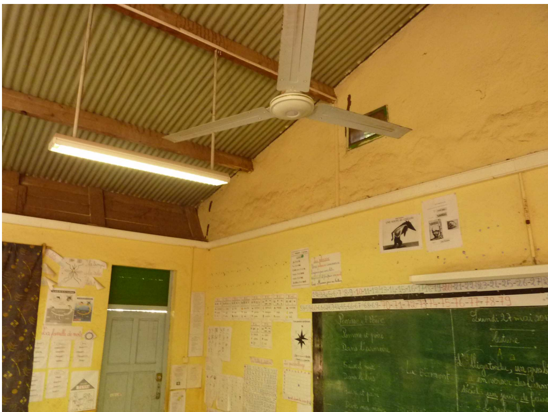
Absence de faux plafond, il n'y a aucune isolation thermique.
