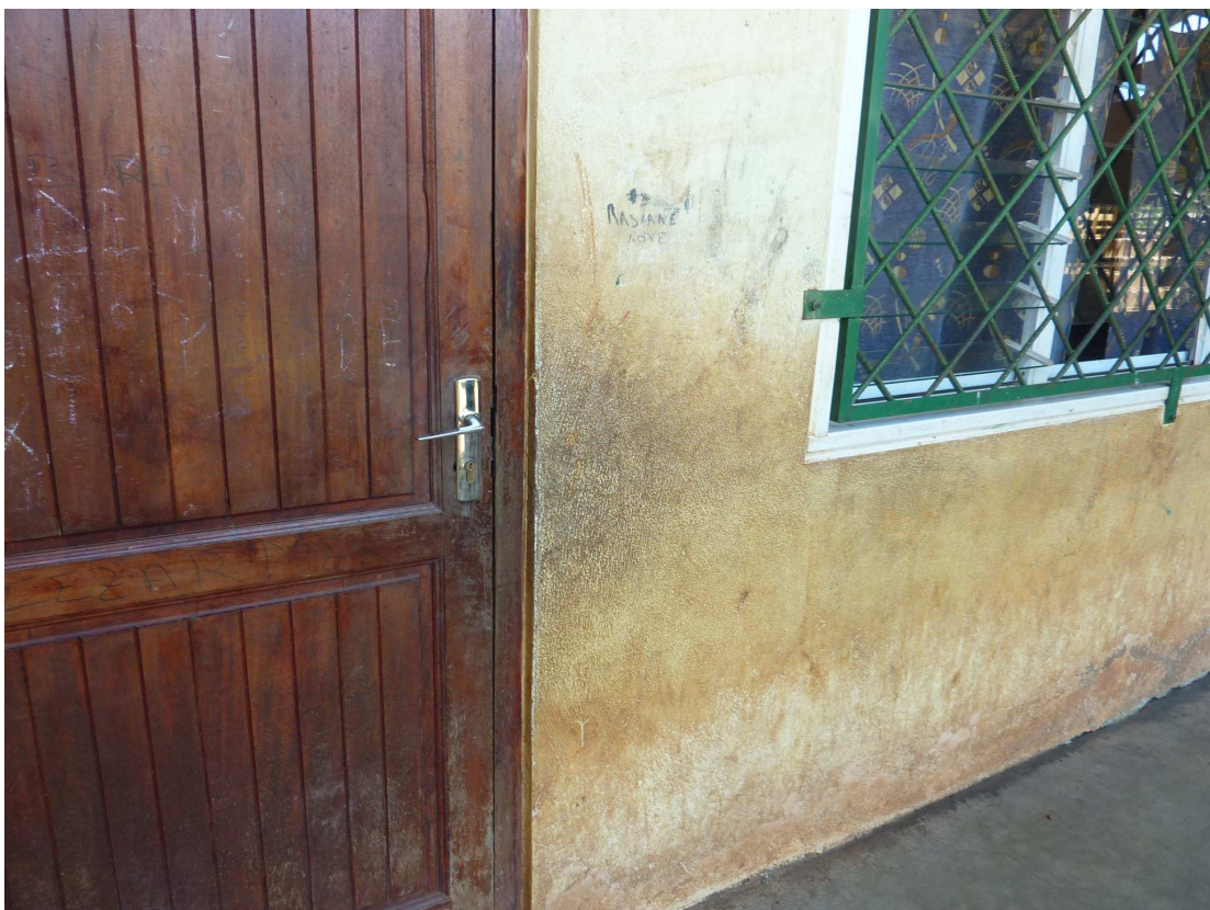
Même lorsqu'ils sont à peu près aux normes, les bâtiments ne sont pas entretenus (pas de peinture).
