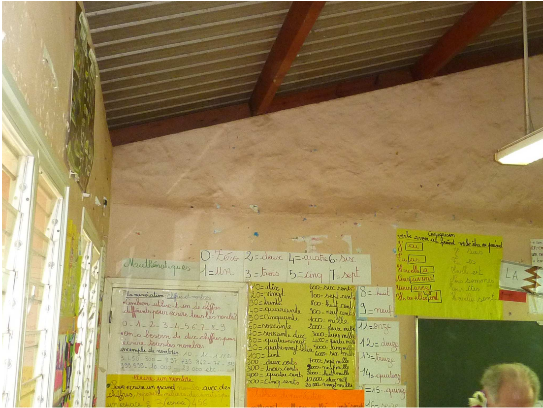
L'impact de l'humidité sur les murs
