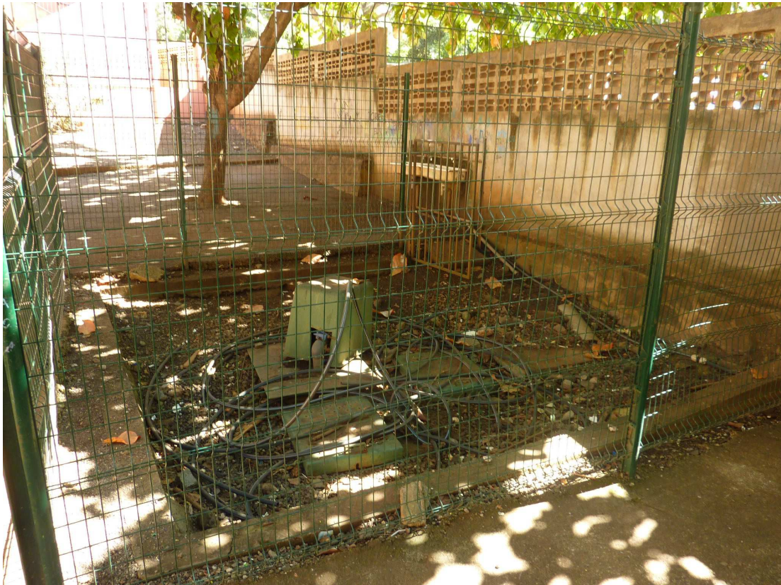
Zoom sur une partie de la cour, où se trouve la fosse septique, qui déborde régulièrement
