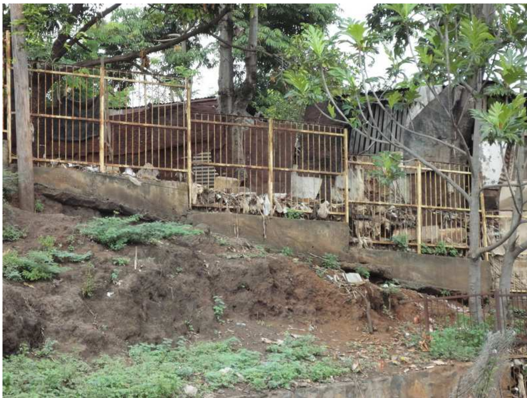
Ecole élémentaire de Koropa 1 (circonscription de Kougou) : les débris se mélangent à la terre qui s'effondre, l'ensemble de ces éléments se retrouvant dans ce qui sert de cour de récréation pour les enfants. © Stéphane Miaux, SNUIPP.
