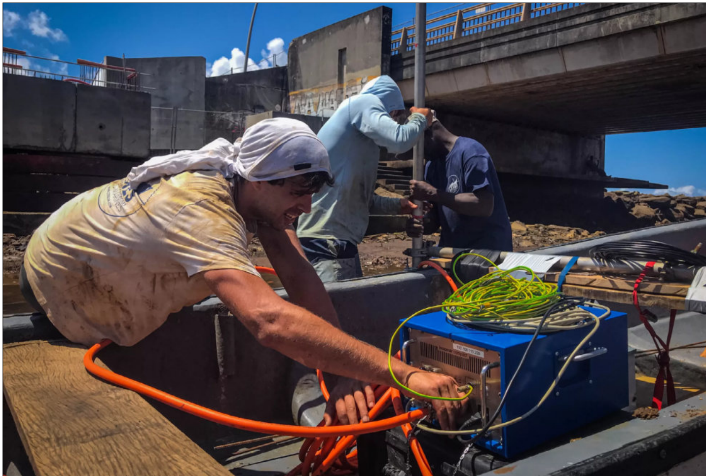
Derniers préparatifs avant l'arrivée des prémices de la marée haute; signal de départ du travail de mesures
