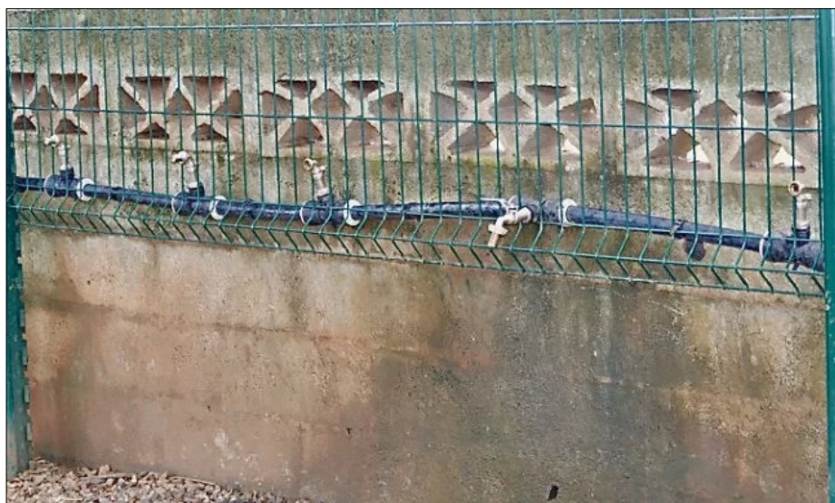
Les rampes d'eau refont leur apparition (ici en février 2017)
