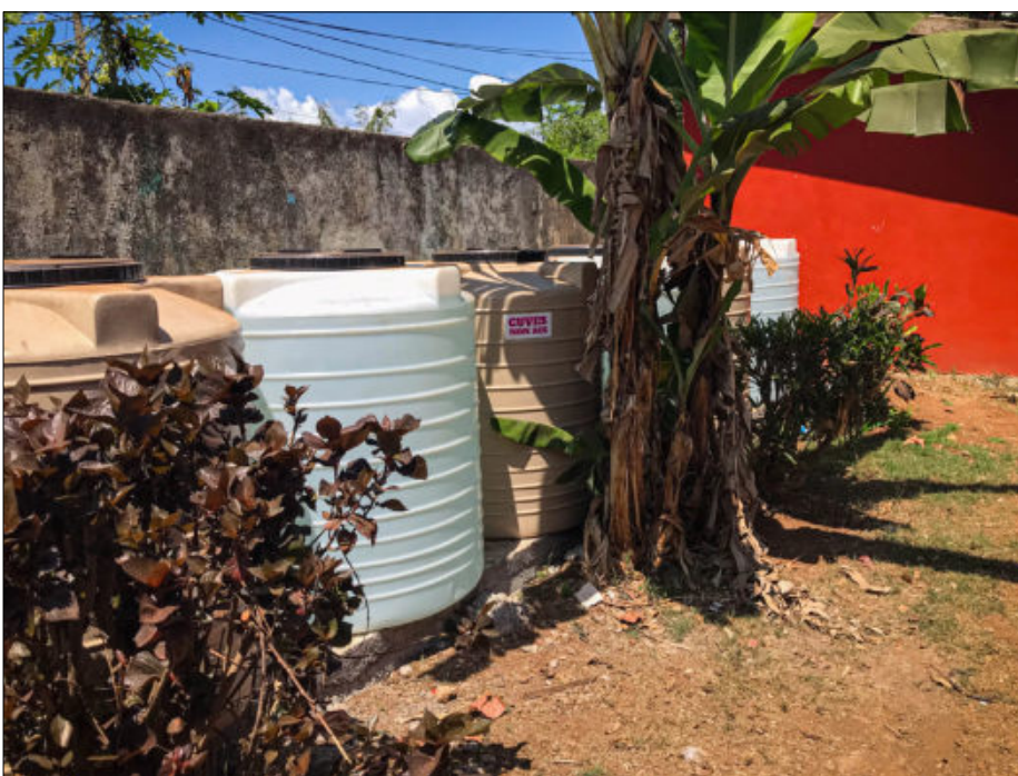
Les nouvelles cuves récemment installées
