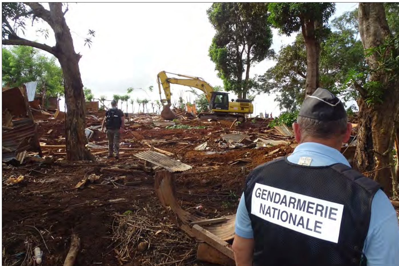
Des futures destructions d'habitats insalubres qui bénéficieront de l'oeil attentif de la LDH
