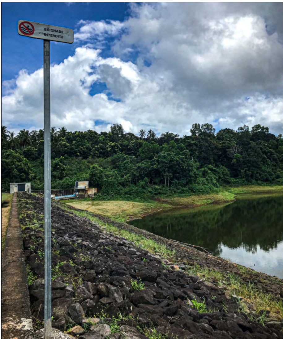
Le niveau de la retenue collinaire de Combani ne cesse de descendre
