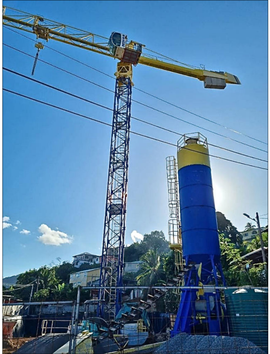
Fin du terrassement sur le chantier de la nouvelle mairie de Sada
