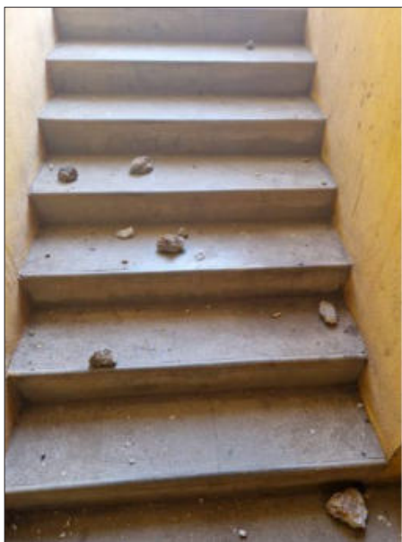
De nombreux cailloux se sont abattus sur la caserne (Photo : SDIS 976)
