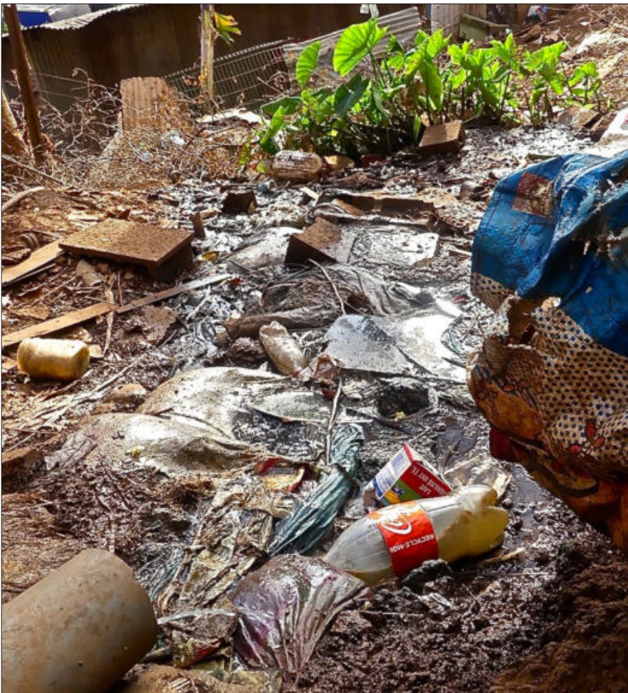
Sortie de liquide nauséabond, en bas à gauche de la photo, et qui s'écoule au milieu des cases
