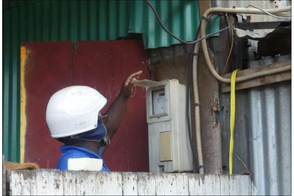
Intervention sur les compteurs par un agent d'EDM qui indique que le courant sera coupé peu avant la démolition
