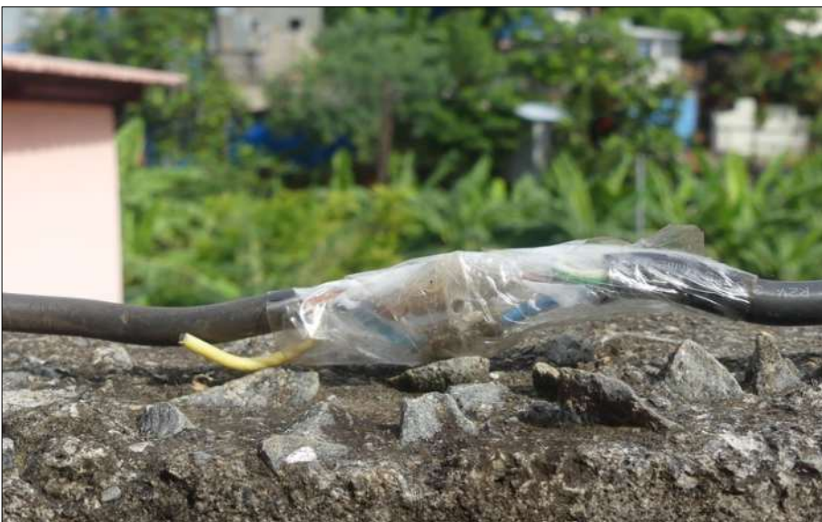
Rafistolage dangereux des câbles électriques
