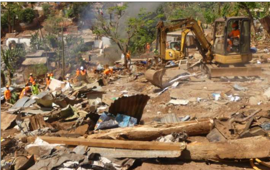
Destruction des cases en tôles de Carobole en septembre 2021
