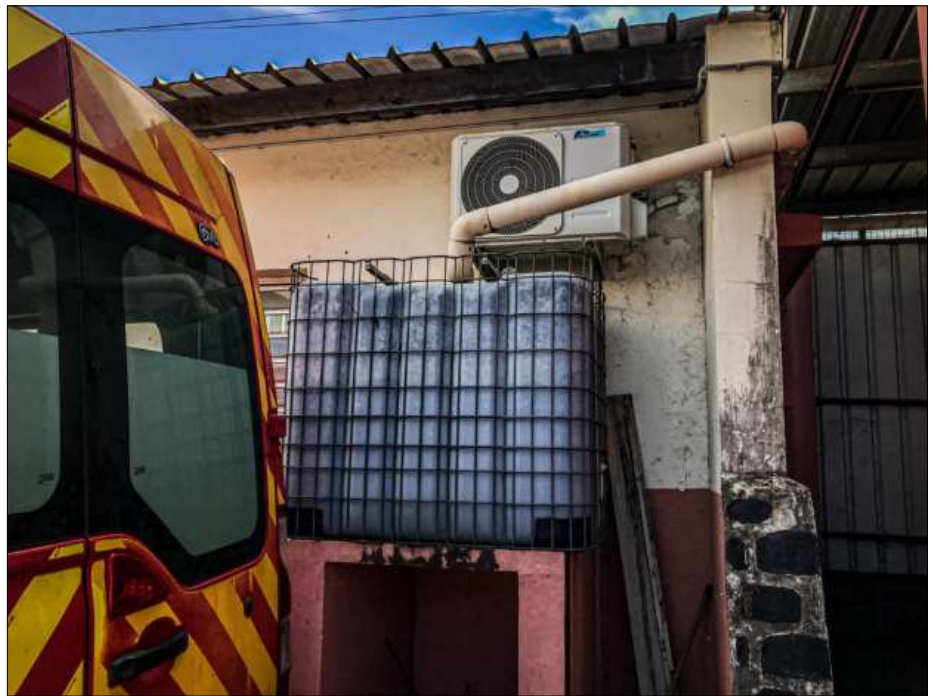
Système de récupération et de stockage d'eau déjà existant au sein du centre de secours principal de Kawéni
